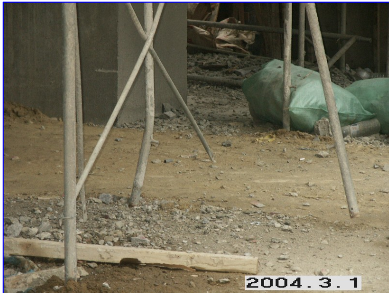
照片 7：施工架之立架腳柱變形，影響施工架之強度。
