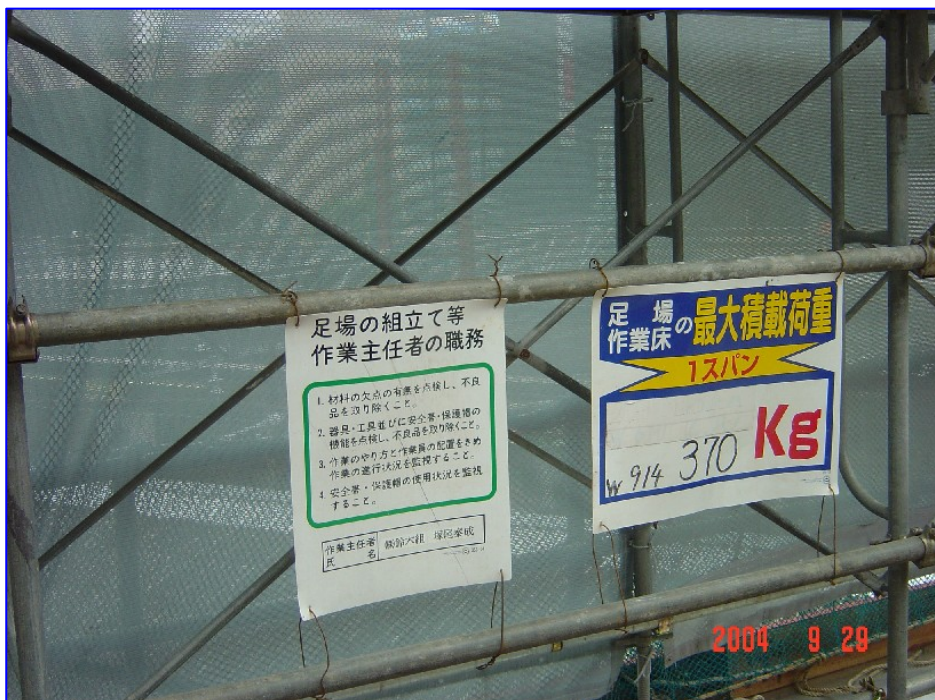
照片 9：施工架上之載重限制應於明顯易見之處明確標示（以標示單一踏板載重限制為原則；另如經設計須標示整組施工架載重限制，則依須求增加標示該內容）。
