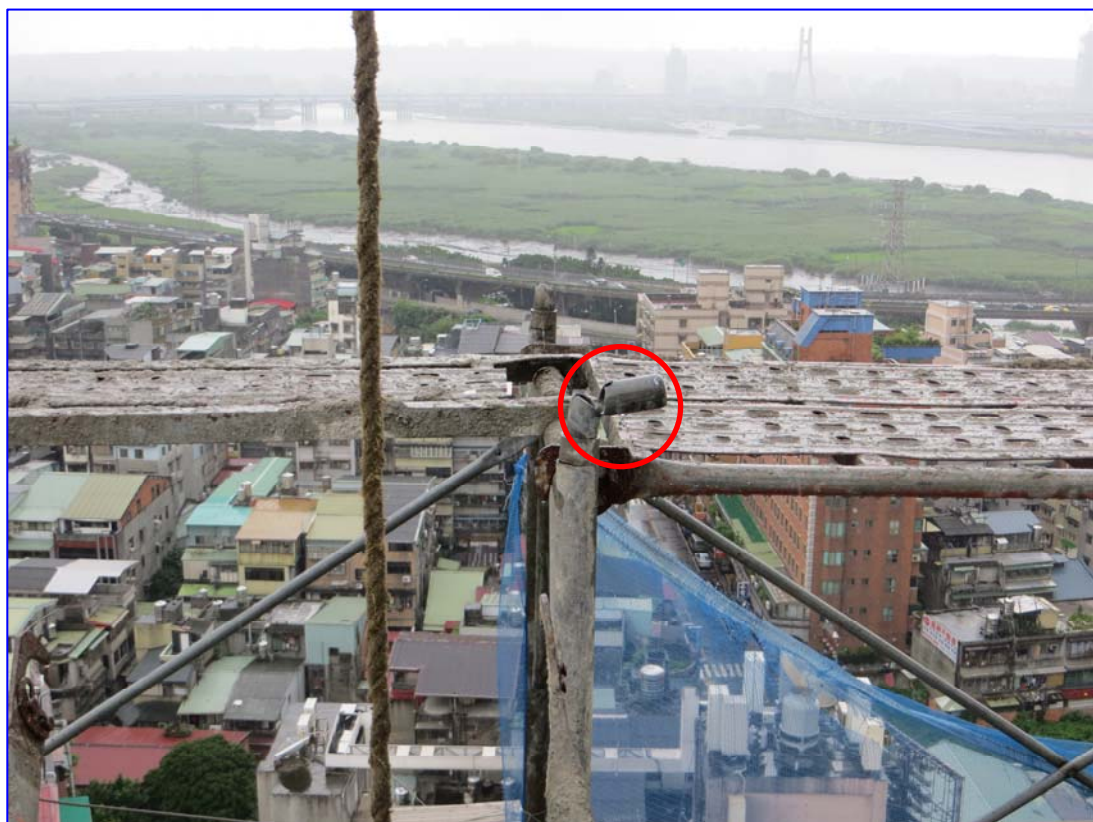
照片 13：未以機械吊運，使用繩索並以立架為支點以人力吊運整捆交叉拉桿及下拉桿，人員隨倒塌之立架墜落（腳柱接頭斷裂）。
